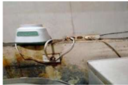
Gambar 2. Kondisi Alat dan Tempat Pengolahan Makanan
